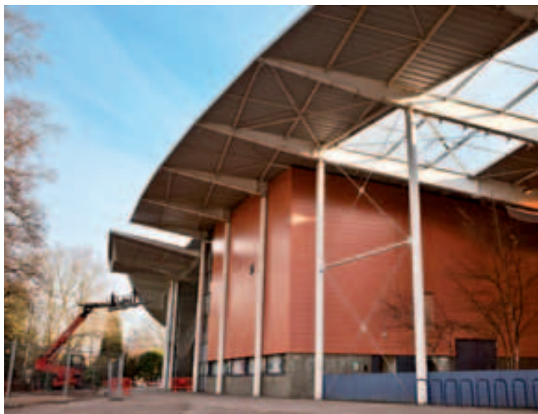
Le changement de toiture devenait essentiel à Saint Exupéry : les infiltrations d'eau étaient en train de s'étendre à tout le bâtiment.
