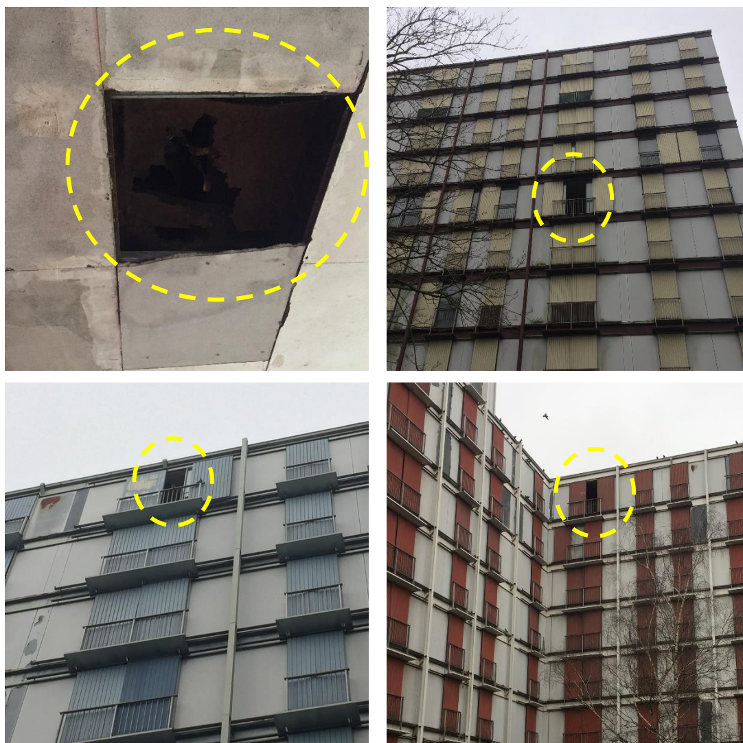
Figure 57 : Fenêtres brisées et ouvertures visibles dans le bâtiment du site
