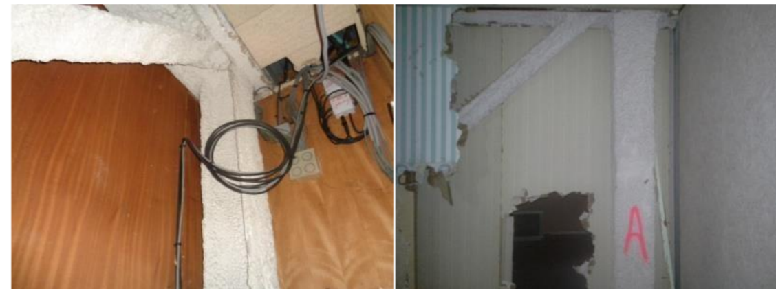
Figure 175 : Enduit amiante sur la structure métallique, Expert Habitat, 2016
