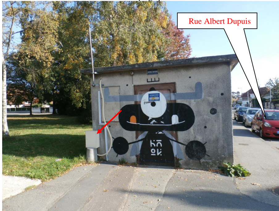
Vue du coffret de comptage provisoire existant
