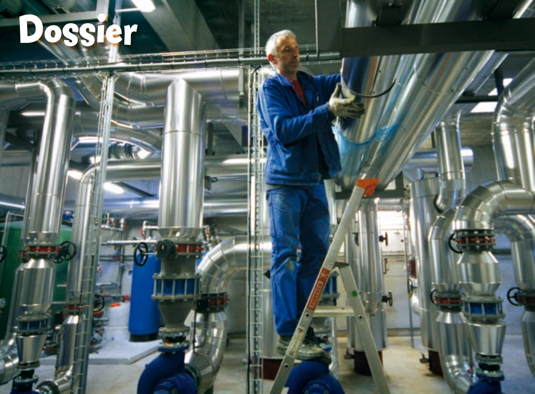
Fonctionnant au bois de récupération, la chaufferie biomasse de Grammont alimente aujourd'hui quelque 1200 logements.
