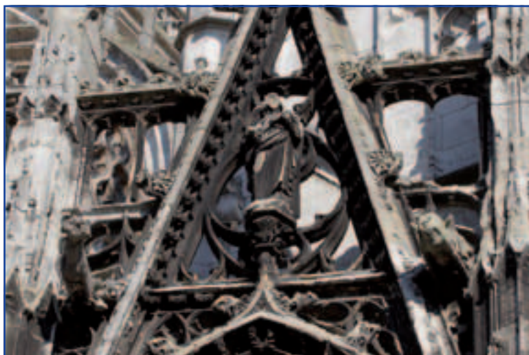
Gros plan sur l'impact du temps qui passe : l'érosion et l'encrassement se conjuguent.
