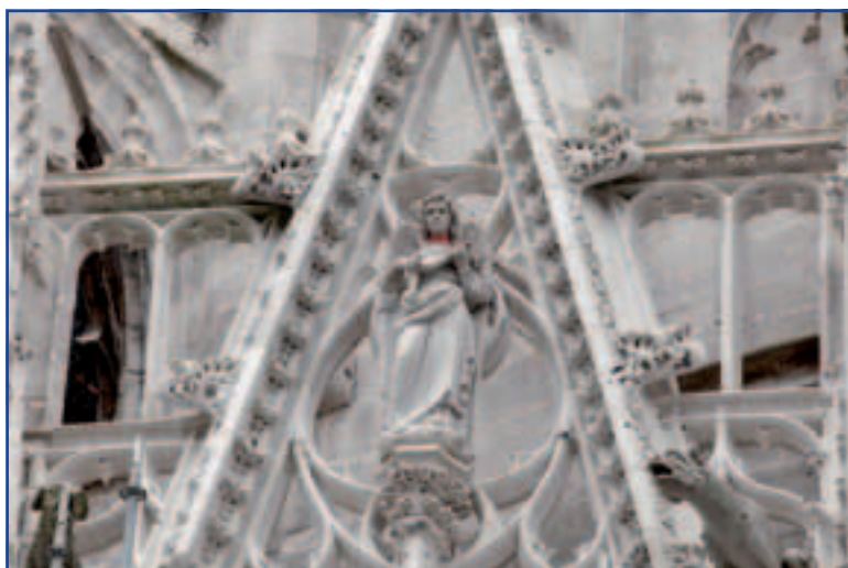
L'effet des travaux : la pierre retrouve sa blancheur et le relief de ses ornements.
