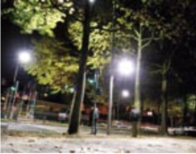
Lumière ! Éclairage public et feux de signalisation prennent un coup de jeune. Un éclairage optimisé et plus économe en électricité.
