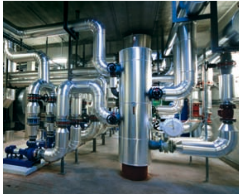
C'est à bois, à bois, à bois... Depuis le 3 avril, le cœur de la chaufferie Grammont brûle pour vous. Subventionné par la Région, l'Ademe et l'Union Européenne, l'équipement subvient aux besoins de 1200 logements, de la clinique Mathilde et de la crèche Terre des Enfants.
