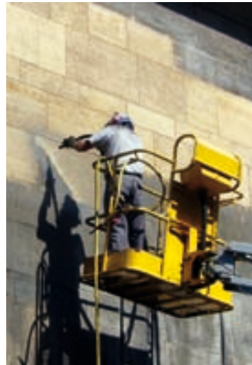
Décapée. Le ravalement des façades de la Halle aux Toiles, de début août à mi-octobre, ne passe pas inaperçu. Un décapage complété en 2010 par la restauration de la fierte Saint-Romain.
