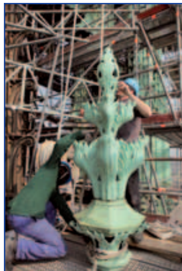
Montage et démontage des éléments : deux opérations à haut risque.
