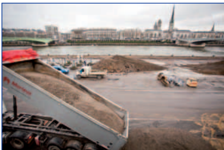
Le chantier d'aménagement se poursuit tout l'hiver. Ici, au mois de janvier.
