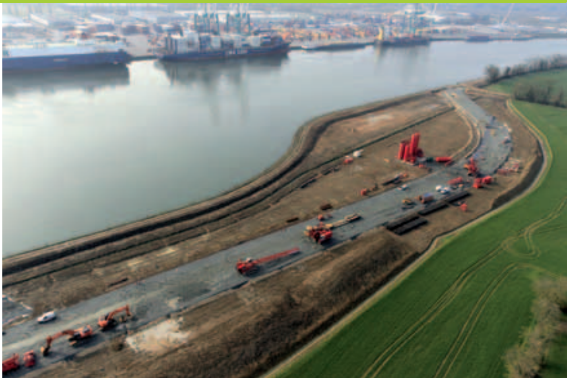
En augmentant la largeur du fleuve, Haropa permet aux navires de manœuvrer plus facilement. Ci-dessus, la zone d'évitage d'Hautot-sur-Seine.
